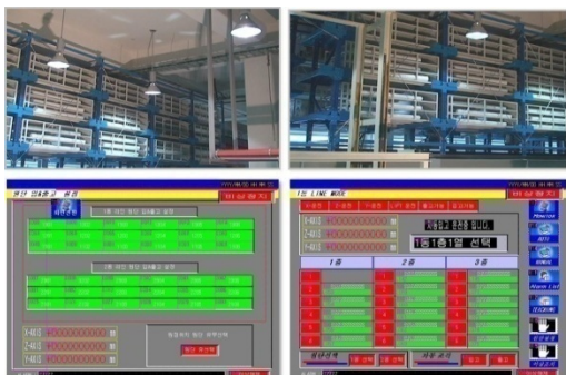
Hệ thống nhà kho tự động cho vải
